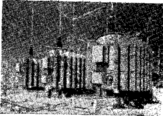
Рис. V.20. Большие трансформаторы, установленные на подстанции.
